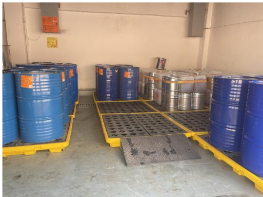
危废仓防漏底盘
