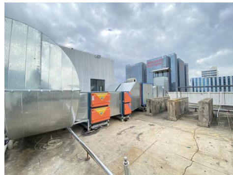
食堂厨房油烟废气处理装置
