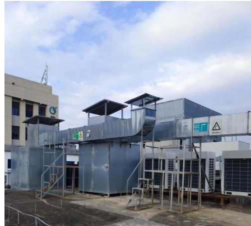
医疗器械大楼楼顶废气处理设施
