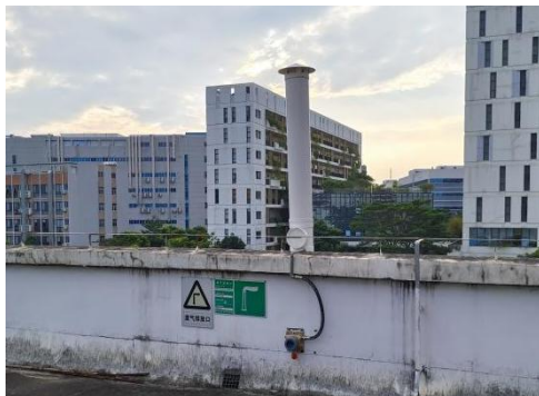
2#公用工程楼顶废气排气筒
