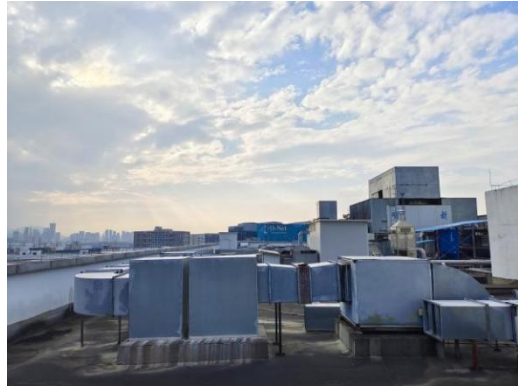
制剂生产大楼楼顶废气处理设施
