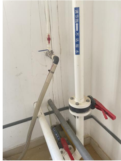
总排口设置开关截流超标废水
