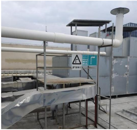
质检车间楼顶废气处理设施
