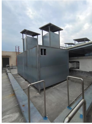
楼顶风机设置加厚隔音房
